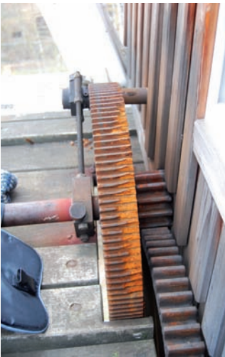
Beschädigtes Windrosengetriebe der Holländerwindmühle Foline
