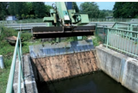
Einlaufbereich mit Rechen an der Wasserkraftanlage
