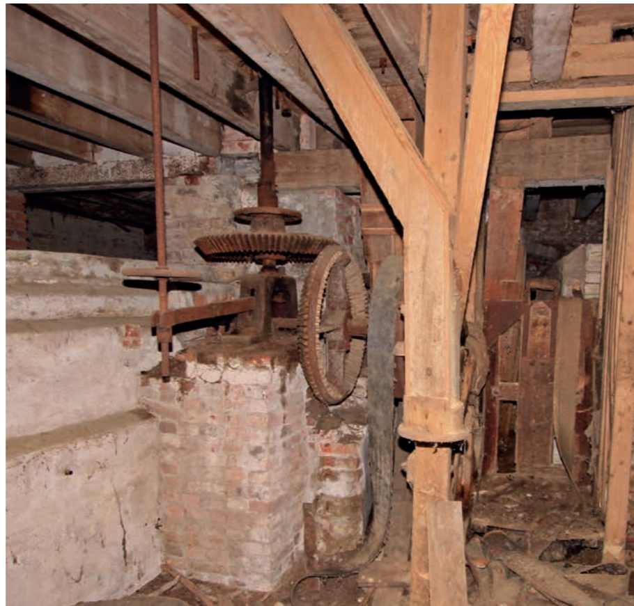
↑ Wassermühle Klein Leppin an der Karthane (Nr. 134) – Antrieb und Lichtwerk des Schrotgangs
