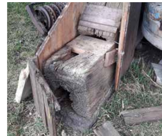
geschädigte Bockschwelle der Bockwindmühle Altbelgern
